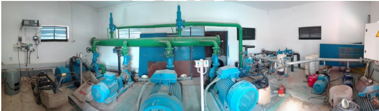
Fotografía 3 Equipos de impulsión.
