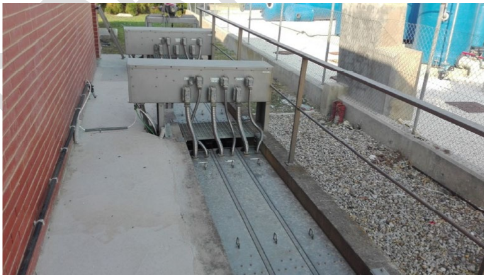
Fotografía 2 Sistema de desinfección con luz ultravioleta.
