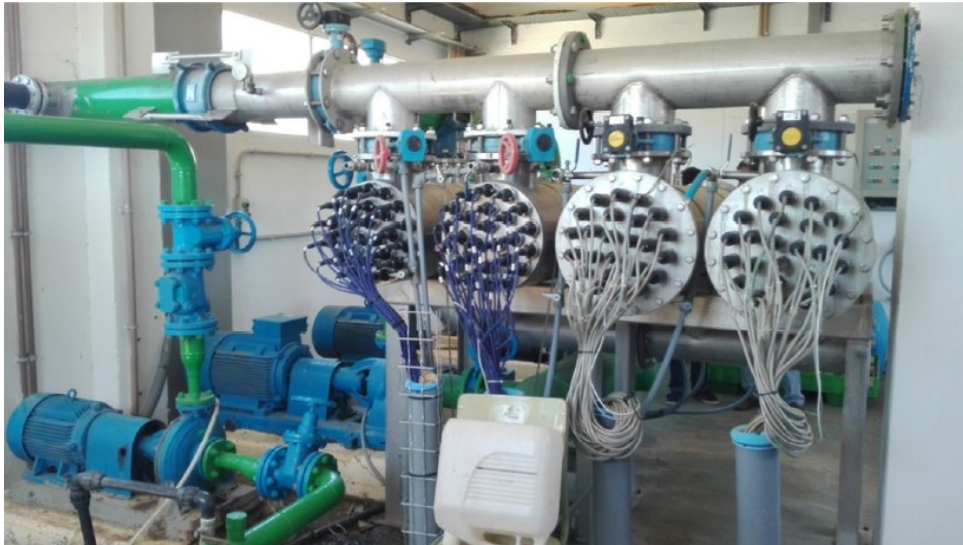
Fotografía 5 Sistema de desinfección con luz ultravioleta.
