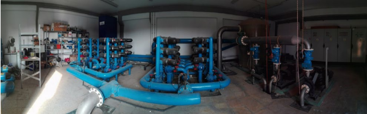
Fotografía 1 Equipo de filtración de anillas.
